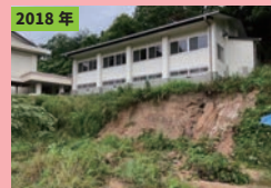
興東館柳生中学校の土砂くずれ
