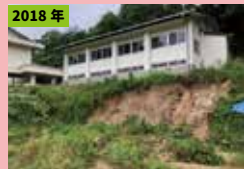
興東館柳生中学校の土砂くずれ
